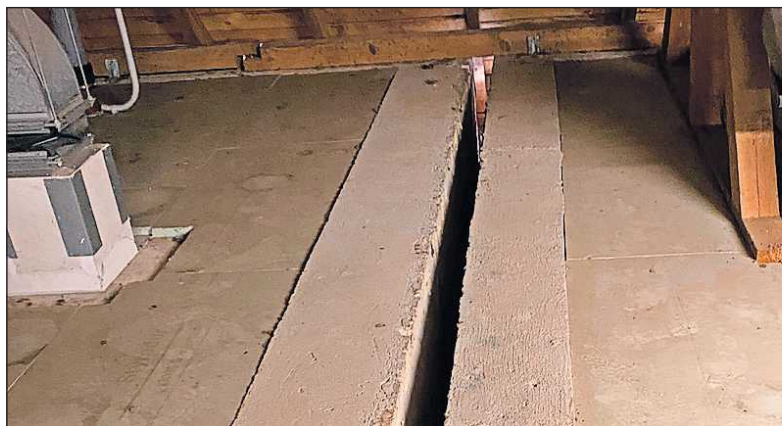
Mit der Leiter auf den Dachboden: Dort sieht man deutlich, wie der Riss die beiden Gebäudeteile trennt.
