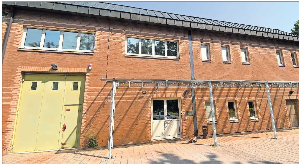
Das Wasserwerk an der K13 zwischen Waldsee und Altrip: In der Mitte der Gebäudefassade ist die dunkle Metallplatte zu sehen, mit der der Riss von außen abgedeckt wird.
